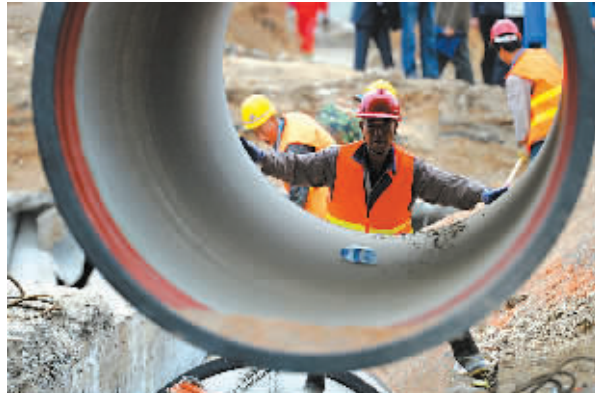
4月14日，施工人员进行输水管道敷设作业。（新华社记者 陈斌 摄）
