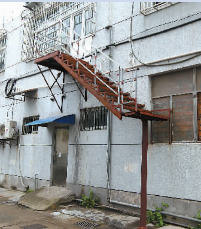
图为违法搭建的楼梯。(本报记者 摄)
