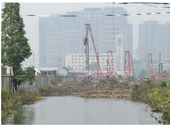
北面河道被渣土完全拦死。
