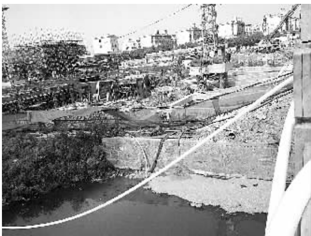
图为网友拍到的工地排放照片。(网友提供)
