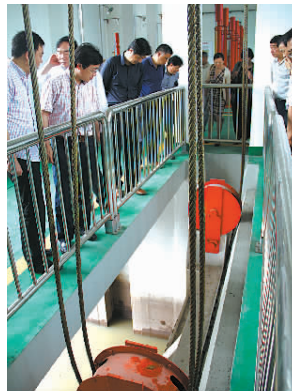
江北区政协主席会议成员专题视察“水利设施建设专项行动”，图为视察张家浦闸站情景。（赵海鹏 摄）
