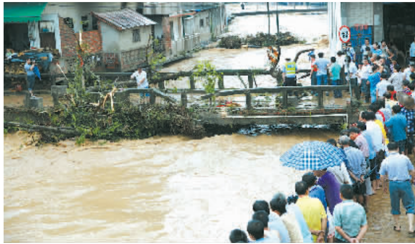
6月21日，广西全州县石塘镇一座桥梁被洪水冲垮。(新华社发)
