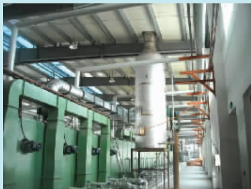
江南化纤定型废气收集治理
