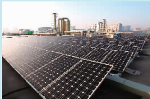
日地屋顶光伏发电项目
