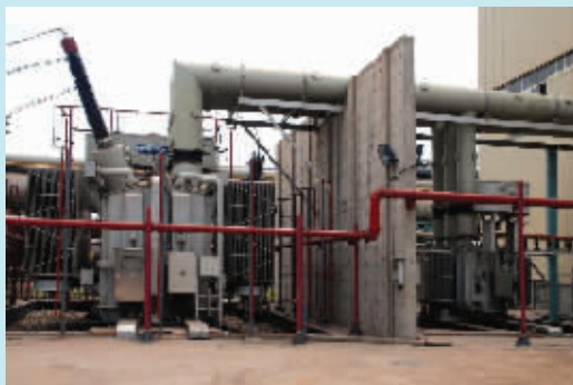
宁钢升压变及厂用变设备
