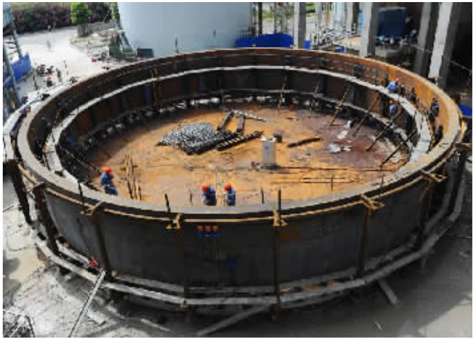
图为正在建设中的北仑电厂7号机组的更大容量的脱硫吸收塔。（张梦雷 摄）
