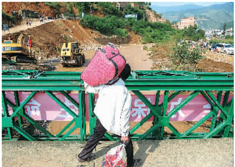
8月6日,一名受灾群众正扛着背包通过新架成的龙泉河桥。通往震中龙头山镇的“咽喉桥”——龙泉河桥8月5日晚顺利架成,这标志着鲁甸地震发生后一直中断的通往震中的道路终于打通。鲁甸地震发生后,龙泉河桥垮塌,致使灾区与外界的联系中断,救援人员只能徒步进入灾区,大批救援物资被堵在途中。
