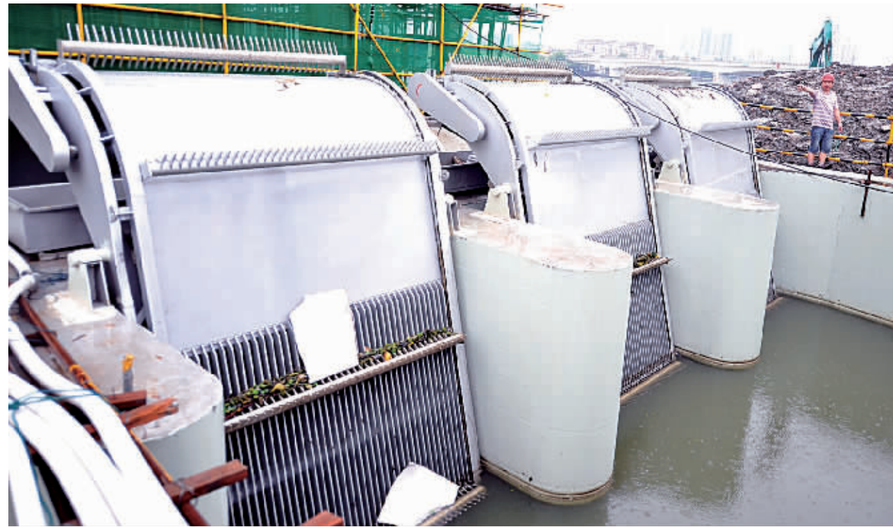
图为投入使用的永丰闸泵站。
