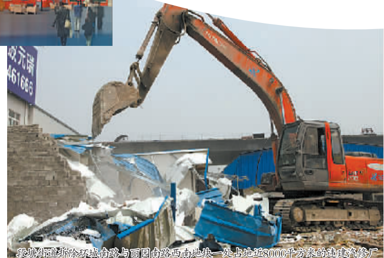
段塘街道拆除环城北路与丽园南路西南地一处占地近8000平方米的违法汽修厂
