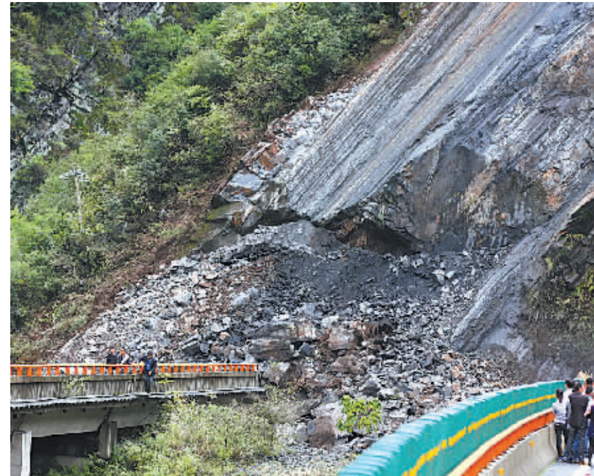
9月16日拍摄的包茂高速西康段塌方事故现场。9月16日上午，包茂高速公路安康至西安方向安沟隧道北口发生大面积塌方，造成该路段安康至西安方向罗瓦湾大桥约30米桥梁垮塌，事故未造成人员伤亡及车辆受损，相关部门正在组织人员进行道路抢修。目前该路段已经封闭，西安往返安康车辆双向均需绕行，通车时间还不确定。（新华社发）
