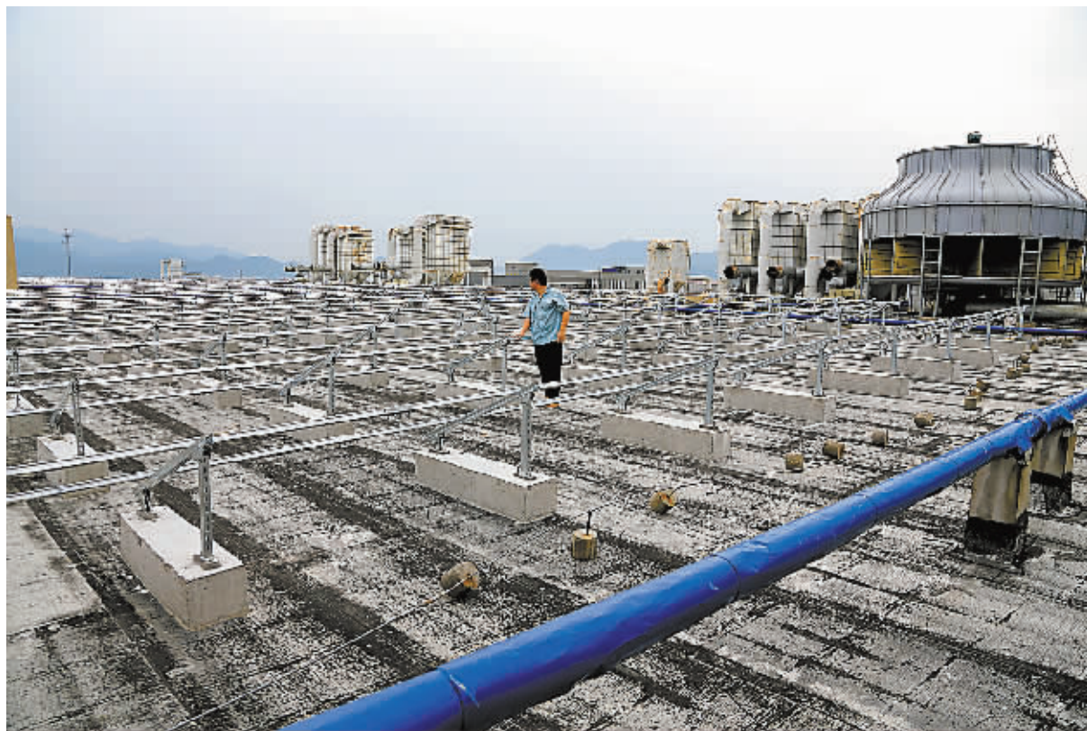
图为海仑钢琴屋顶分布式光伏发电项目已完成太阳能电池板支架安装。（记者 张跃 摄）
