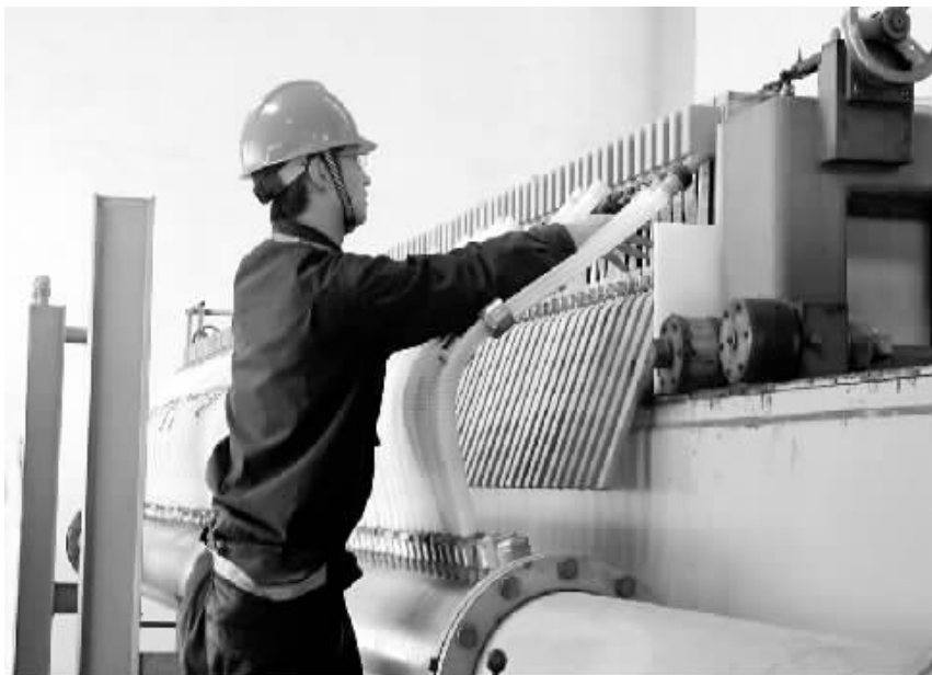
图为万华(宁波)氯碱公司氢气回收设备。(韩栋 摄)
