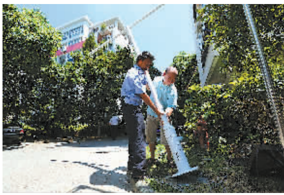
望春天一家园安装监控
