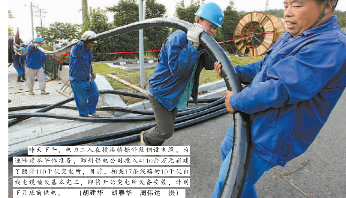
昨天下午,电力工人在横溪镇栎社段铺设电缆。为迎峰度冬早作准备,鄞州供电公司投入4110余万元新建了慈学110千伏变电站,目前,相关17条线路的10千伏出线电缆铺设基本完工,即将开始变电站设备安装,计划下月底前供电。(胡建华 胡春华 周伟达 摄)
