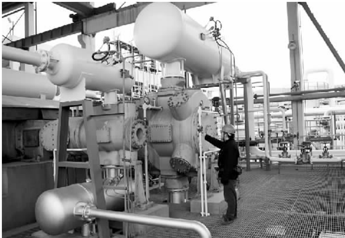
万华（宁波）氯碱公司员工正在巡视生产装置区。（记者 李平 摄）
