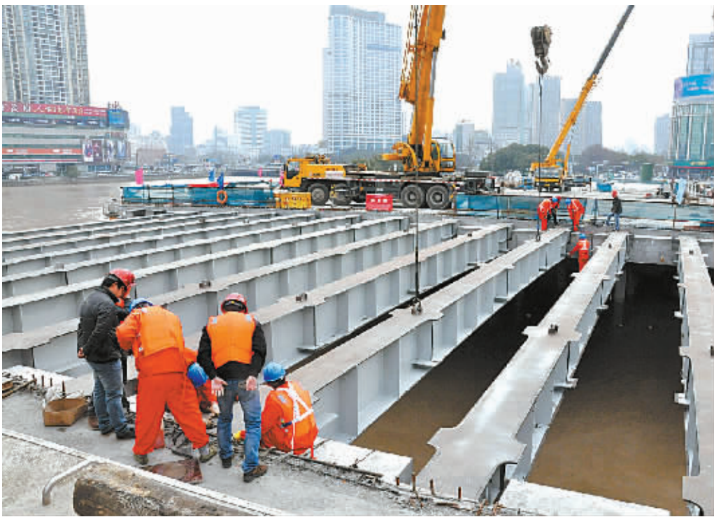
目前，大桥在海曙、江北两头陆地的所有工程桩基施工已经完成，全面转入水上作业阶段。(刘克明 摄)
