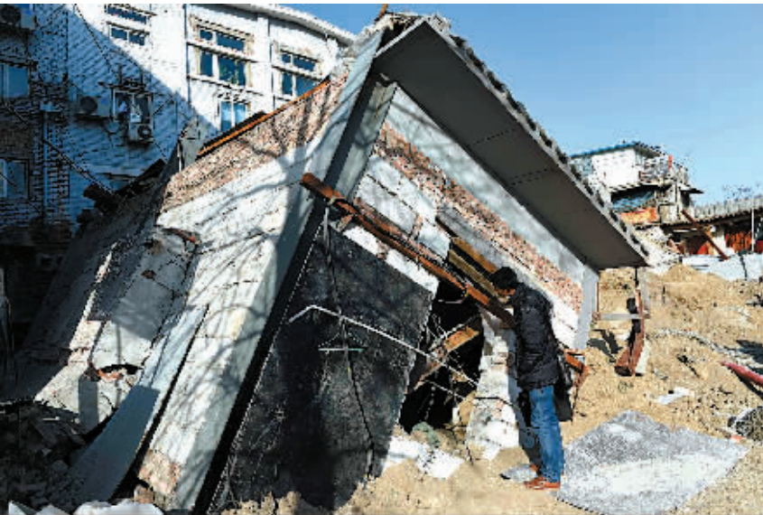
1月28日，一名工作人员在北京市德内大街93号院塌陷现场查看倒塌的建筑。
