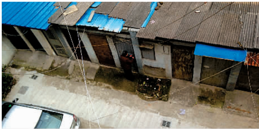
电线当空乱拉是许多老小区的通病。(沈孙晖 摄)
