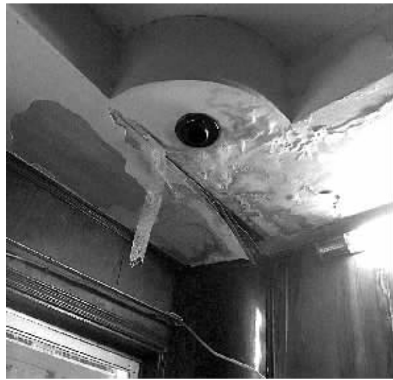
▲魏先生家卧室顶已漏得“脱皮”。 ▲有些居民家的下水管就像这根生铁管已烂孔。(沈孙晖 摄)
