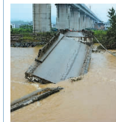
5月22日拍摄的被洪水冲断的广西桂林市恭城瑶族自治县孟家大桥。 (新华社发)
