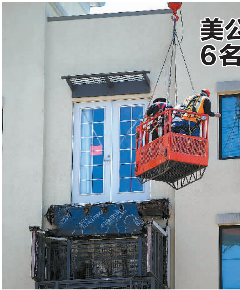
6月16日，在美国加利福尼亚州伯克利市，工作人员检查坍塌的阳台。(新华社/法新)
