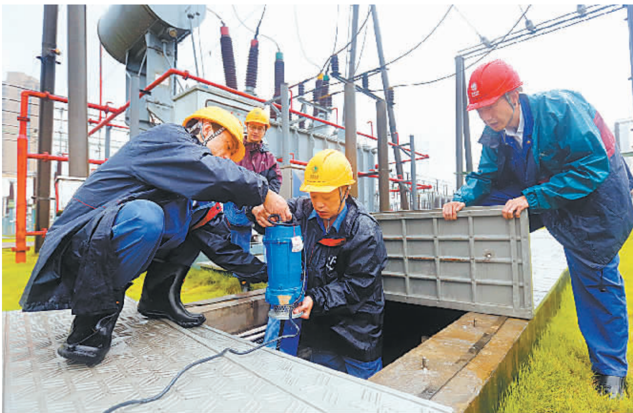
昨日，国网宁波供电公司工作人员用移动式水泵对电缆沟等部分低洼区域进行排水。台风逼近，重点变电站以及曾经受淹的低洼地段设备成为供电部门特巡、检查的重点。（王幕宾 冯璋 摄）
