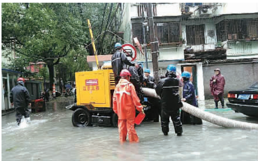
图为江东城管职工正在荷池新村抽排积水。(曹爱方 包静琴 摄)
