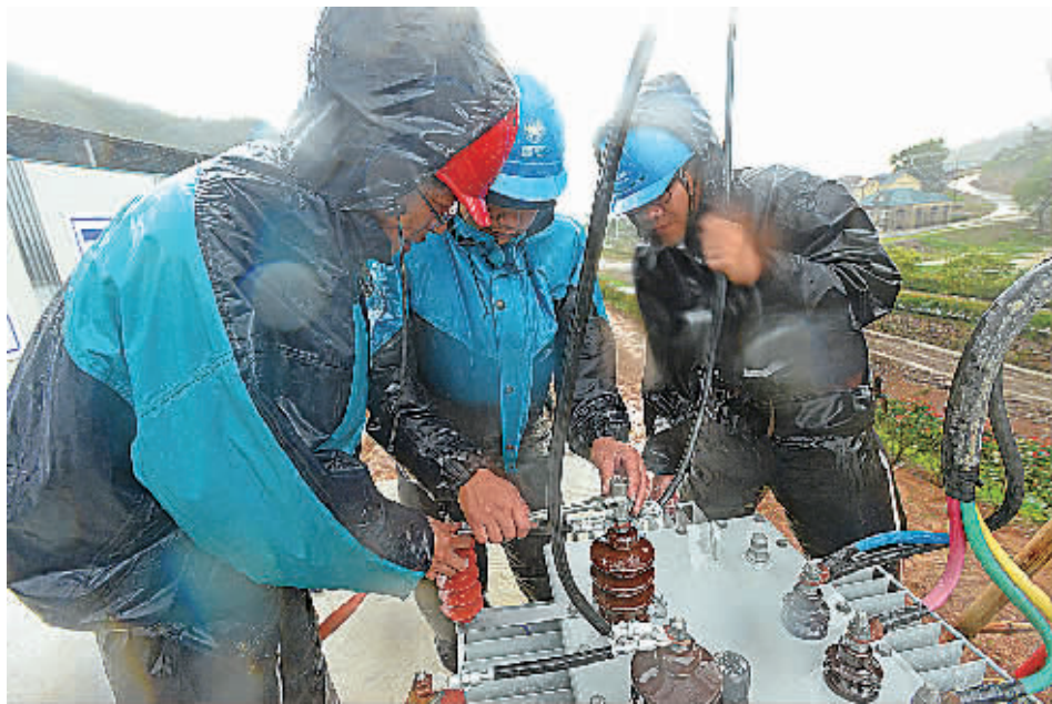
昨天下午，象山电力公司新桥抢修小组工作人员正冒着狂风暴雨抢修该镇黄吉杏村的高速连接线中交一局临时基建变电站。短短12小时里，该抢修小组已成功抢修电力事故16起。（徐能 陈光曙 摄）
