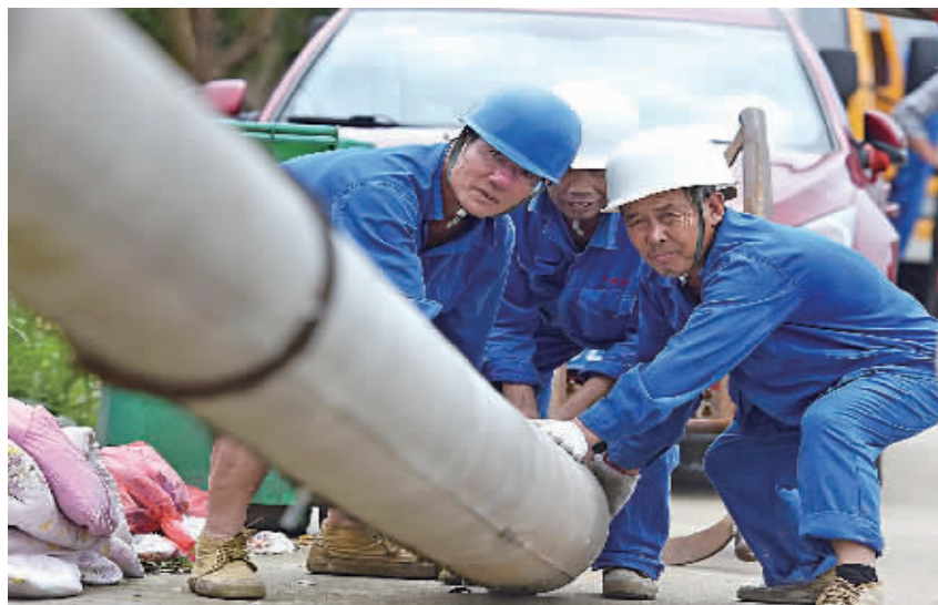
昨天，鄞州供电公司鄞江供电所工人正在上凌村更换被台风刮断的电杆。 (徐文杰 胡春华 摄)
