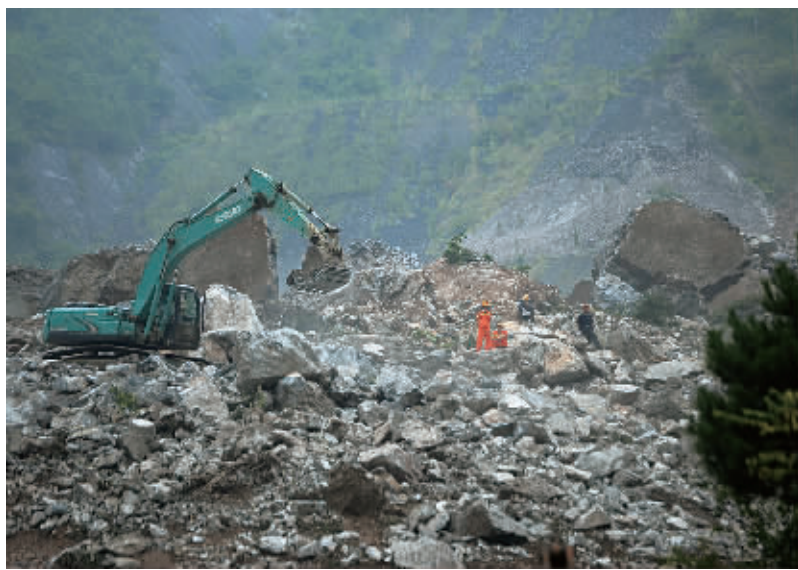
8月12日,抢险人员在山体滑坡事故现场清理土石方。(新华社发)
