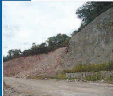
治理前的小港滨江汽车城南侧山体边坡。
