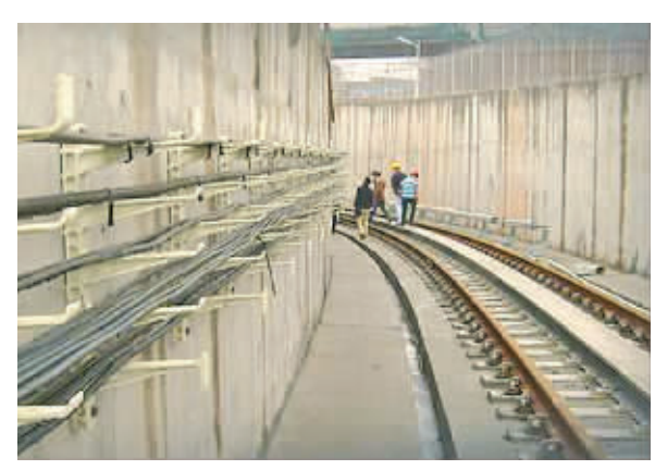
检查复合电缆支架
