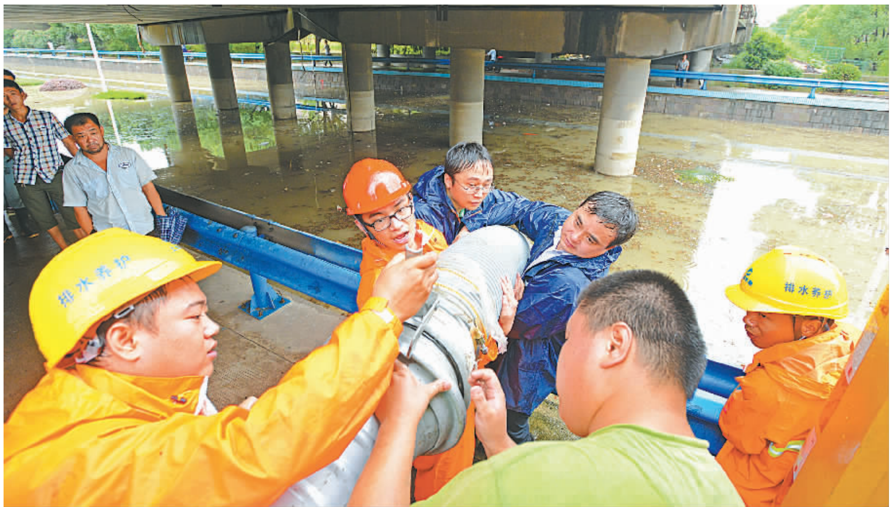
昨天上午,在鄞县大道与宁横路路口,鄞州区域管局工作人员正在进行下穿通道强排水。
