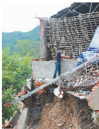
塌塌的房屋。(余建文 摄)
