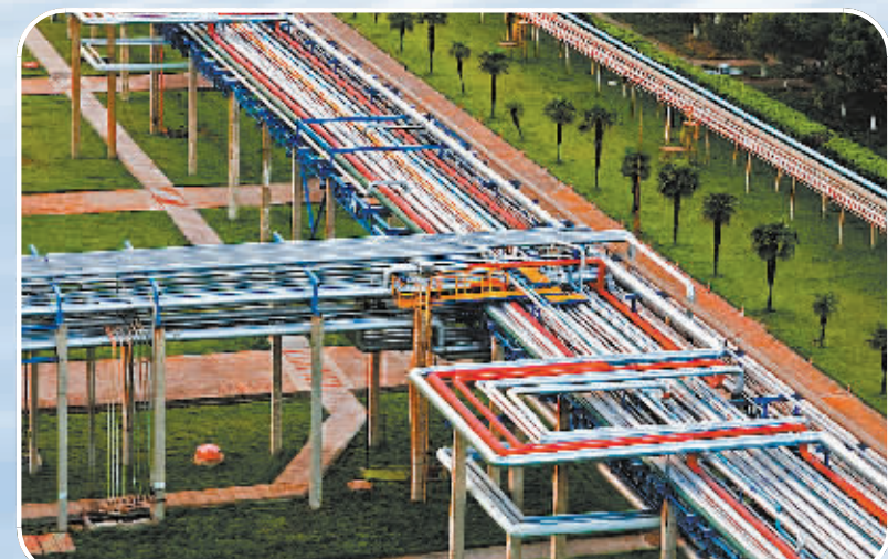
物料运输用管道，既安全、环保又便捷。宁波石化区的化工管廊也是一道靓丽的风景线。
