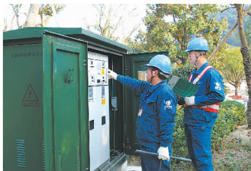
电工在查看线路。区、风景区智能化建设和应用水平将大幅提高,供电可靠率达到99.99%,用户年均停电时间不超过1小时,供电质量达到国际先进水平;农村地区供电能力与供电安全水平显著提升,供电可靠率在99.97%以上,用户年均停电时间不超过2.5小时,由此保障地区经济社会快速发展和群众舒心用电。
