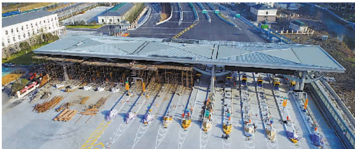
图为杭甬高速宁波(新)收费站。
