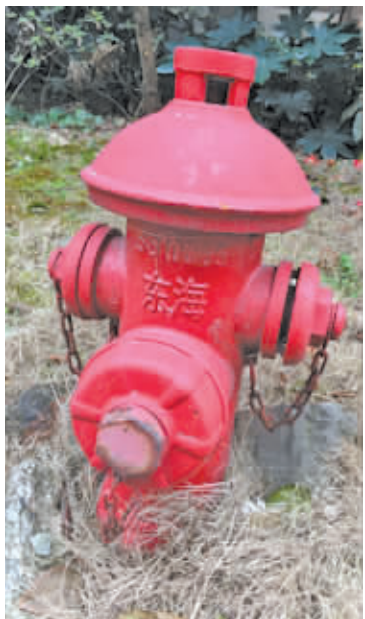
西堤阳光小区的消火栓随处可见，可惜里面一滴水都没有。
