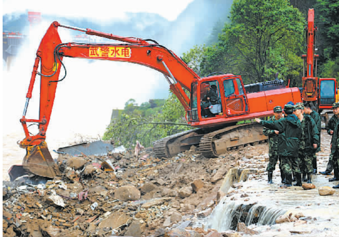
5月10日，参与救援的武警水电部队重型机械在福建泰宁山体滑坡灾害现场开展救援工作。(新华社发)
