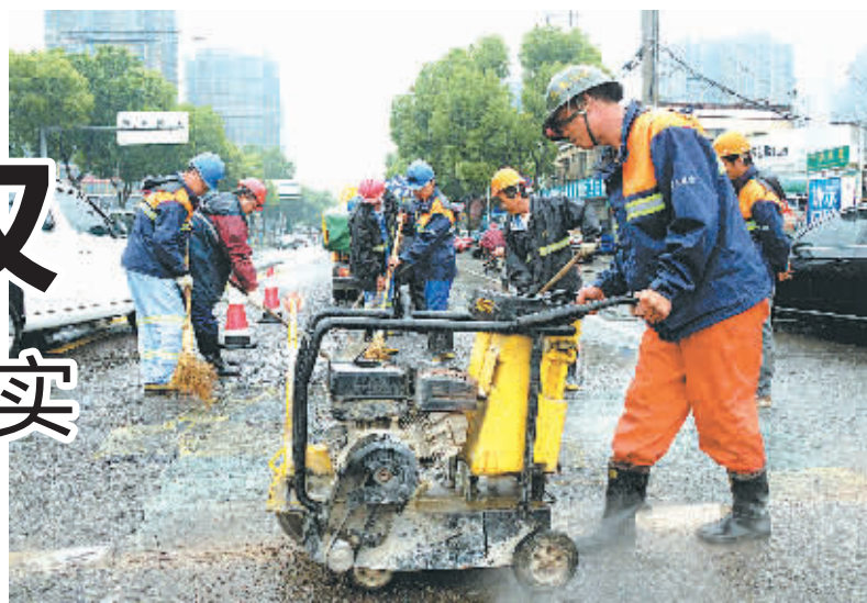
图为昨天下午，江东城区管局市政养护应急抢险班组在江东北路与中兴北路交叉口对马路坑洼处进行修复。（记者 陈章升 摄）
