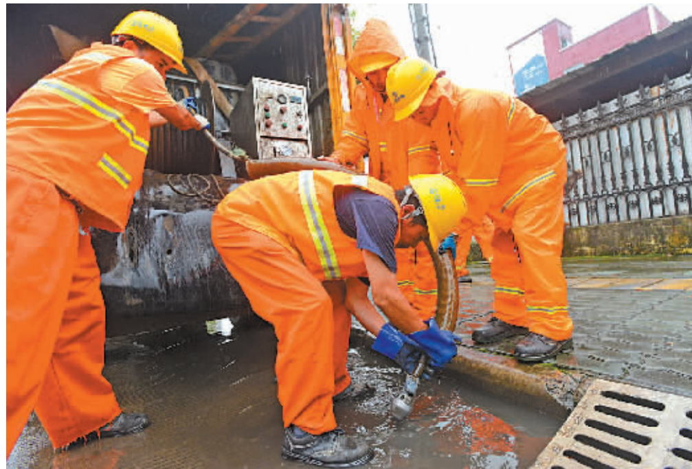
昨天上午,短时强降雨致城区部分路段积水。为确保行人安全和道路畅通,各部门紧急开展疏通管网、排除积水作业。图为鄞州区城管局排水养护人员在嵩江东路清除积水。(徐能 朱娇娇 摄)
