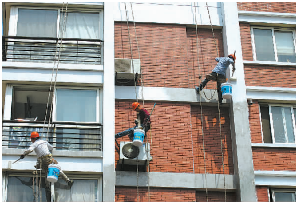
昨日，建筑工人正在对江东南路沿线某小区住宅外立面进行整修。（郑旭辉 摄）
