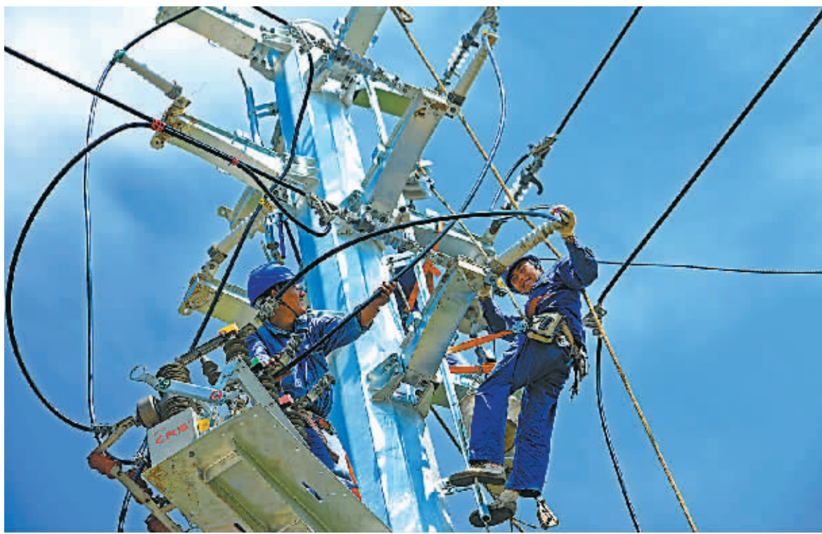
昨天上午,在马渚镇安乐湖村,电力工人正在烈日下改造一条10千伏线路。
