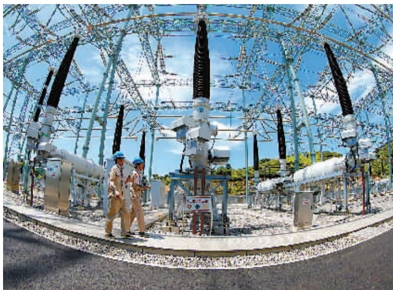
上半年新建的宁波第一座500千伏智能变电站——明州变。(仇九鼎 王嘉宾 摄)
