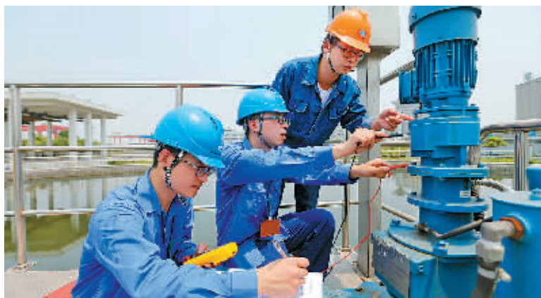
电力工作人员检查污水池控制系统供电线路设备。(仇九鼎 王幕宾 摄)
