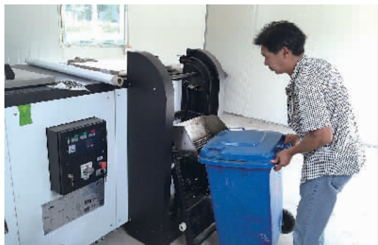
操作员在餐厨垃圾生化机前工作
