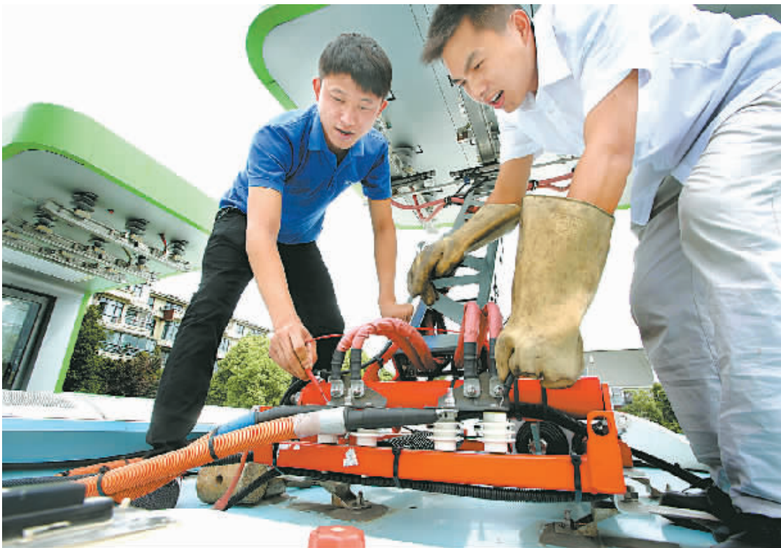
昨天,市公交总公司组织有关单位技术人员,在公交洪塘塘和名苑场站对充电桩进行车辆充电调试。经过前期线路踏勘和反复论证,市公交总公司首批超级电容公交车不久将投入试运营。据悉,这批新能源车将投放到306路。(徐文杰 毛敏尔 摄)
