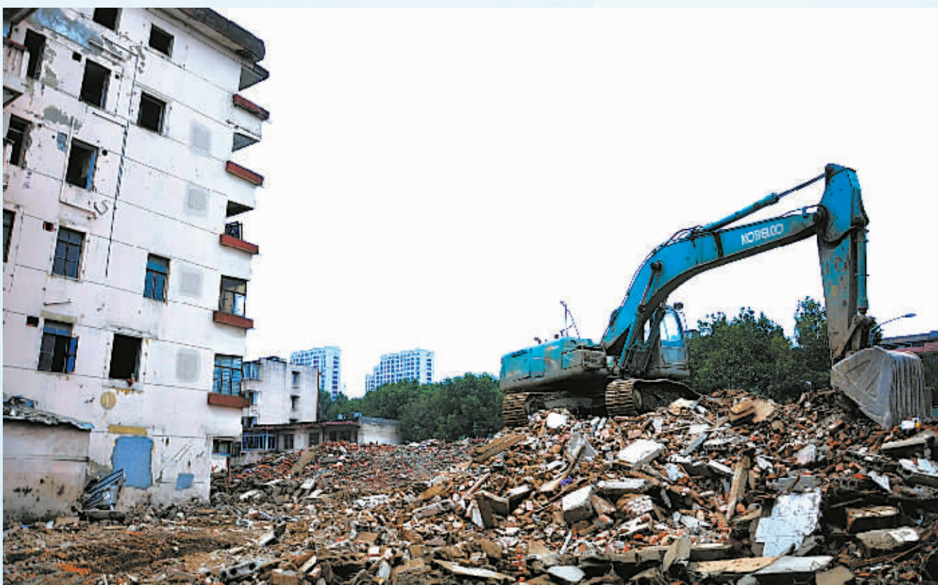
全市首个成片征收改造的徐或小区目前进入房屋拆除阶段。
