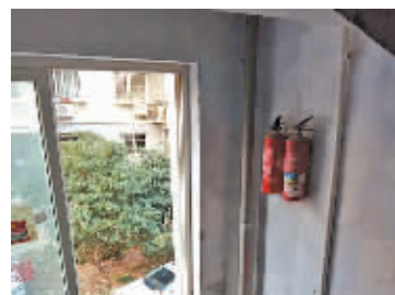
一樓和二樓之間的過道均已配上了滅火器。（石景 攝）
