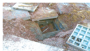
中兴路口的窨井未有防护设施。（仇龙杰 摄）
