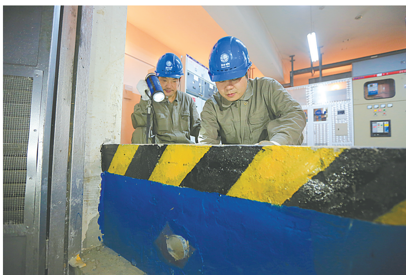
“风雨无忧”工程,让老百姓用电无忧。(郑之超 摄)
