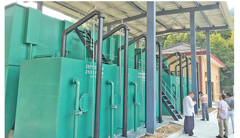
图为已经建设好的金峨片区饮用水处理设备。(王博 叶柳寅 摄)
