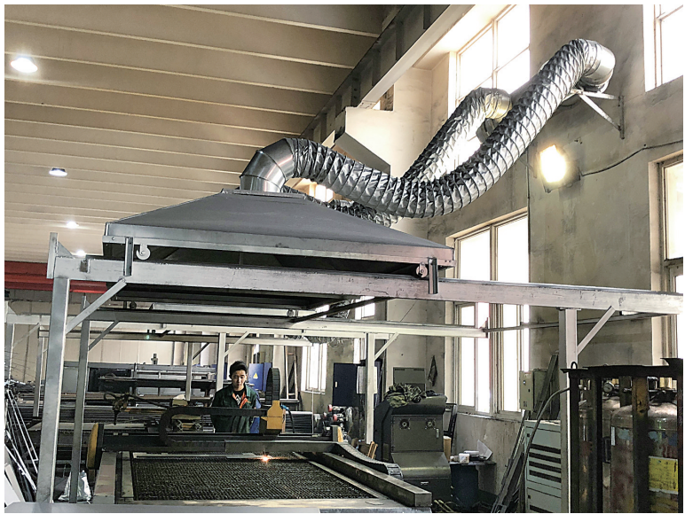
尚恒机械厂生产车间已经在运行的除尘设备。（冯瑄 摄）
